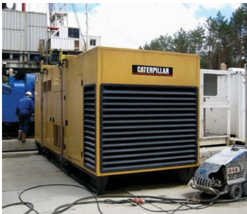
8 pav. Elektros tiekimo dyzelgeneratoriai
